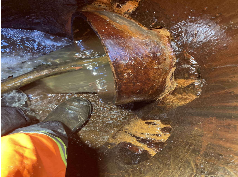
Jonction conduite d'évacuation chambre des vannes (16 po dia.) et manhole, craques
