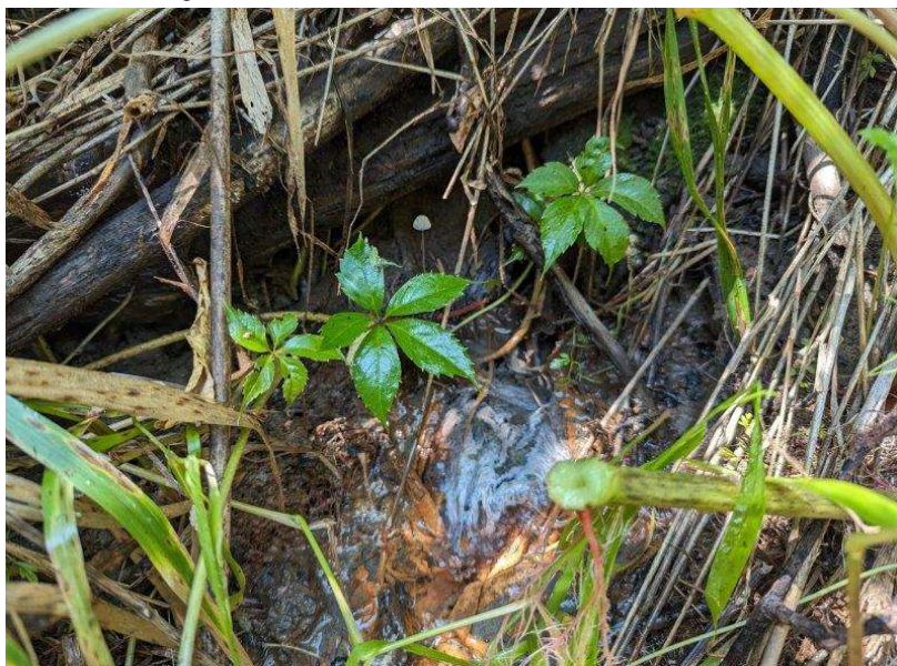
Photo 5 : Résurgence au pied aval de la digue
