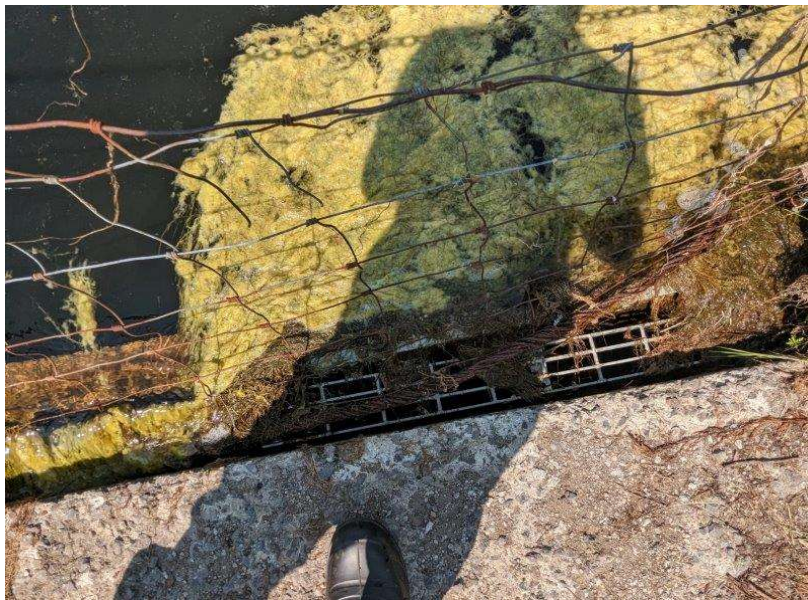
Photo 3 : Obstruction du seuil inférieur par des algues
