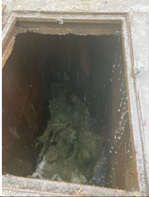
Photo 1 – État de l'intérieur de la chambre de contrôle du barrage, les vannes se trouvaient sous cet amas de débris végétaux et de sédiments (2023-07-27).
