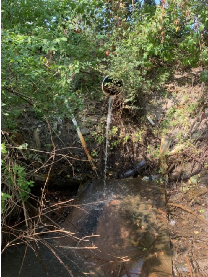
Photo 7 – Écoulement observé à la conduite d'évacuation du barrage Béram (2023-09-25).
