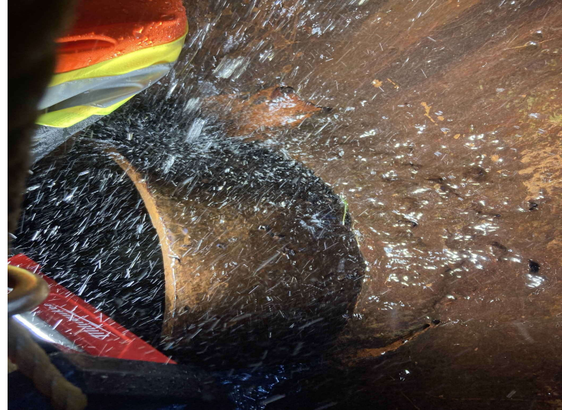
Jonction conduite d'évacuation globale (16 po dia.) et manhole, craques
